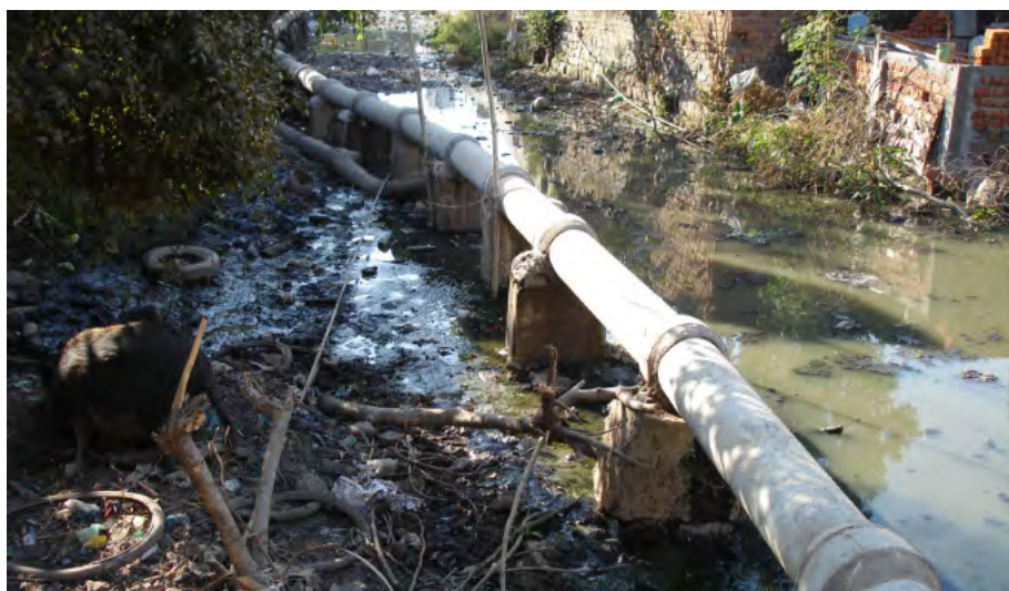
Canos de esgoto e águas residuais, Bhopal, Índia
